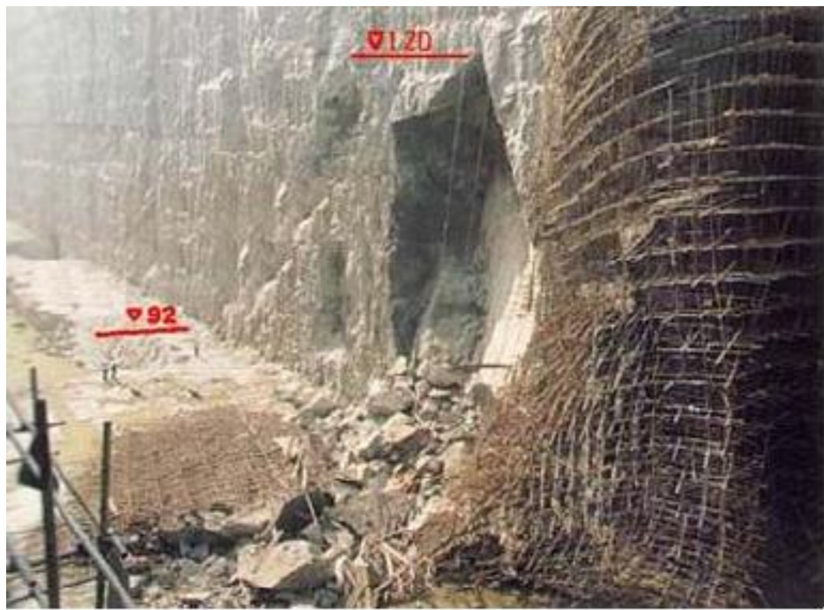
三峡船闸开挖块体垮落 [1]
